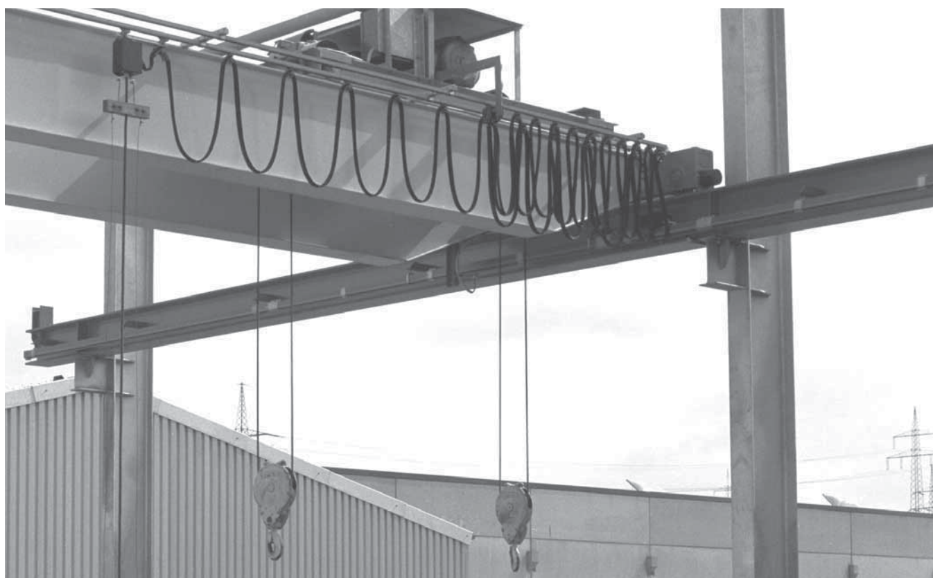
Chariots porte-câbles pour l'alimentation d'un chariot de pont- roulant
